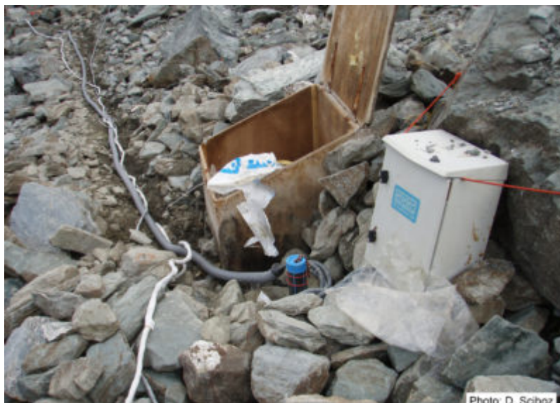
Fig. 5 – Site de forage de l'éboulis des Lapires installé en 1998 (Val de Nendaz, VS).
