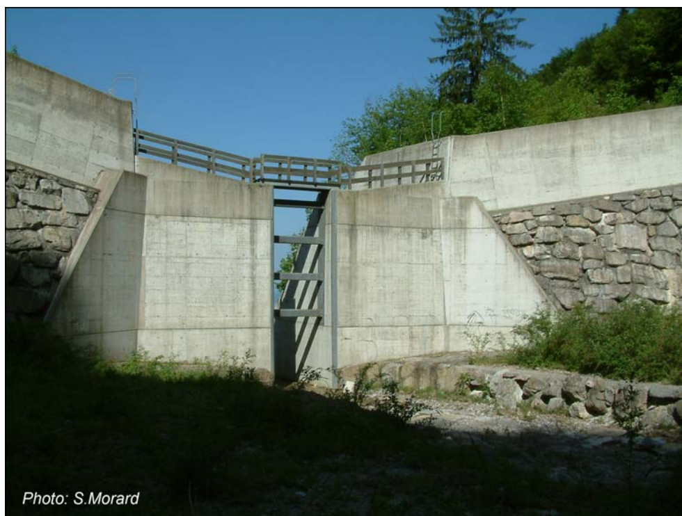
Fig. 5 – Ouvrage de protection à effet “brise-lave” contre les laves torrentielles (Villeneuve, VD).
